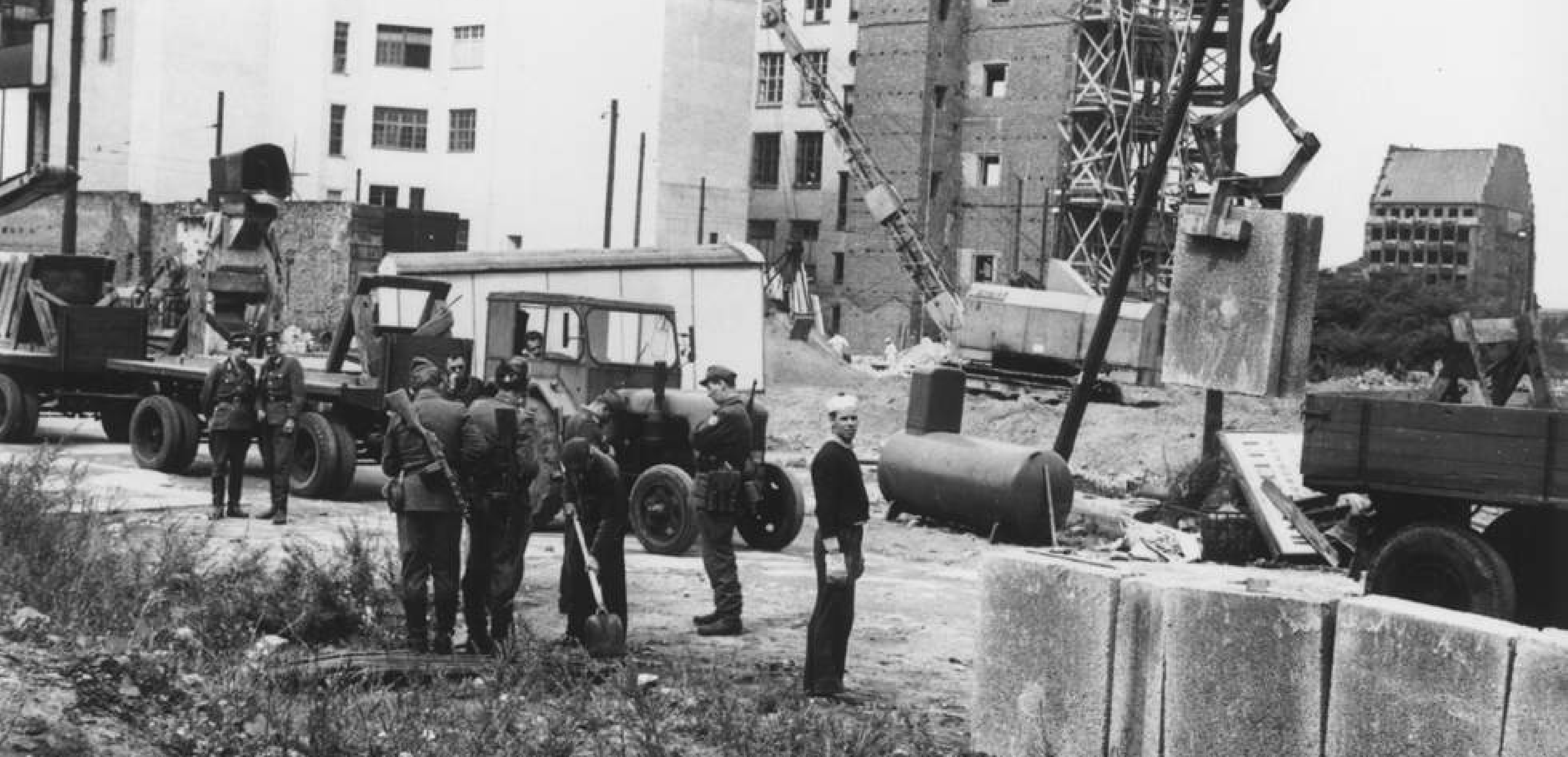
Alcuni militari della Germania Est supervisionano la costruzione del muro, nell'agosto del 1961(Central Press)
